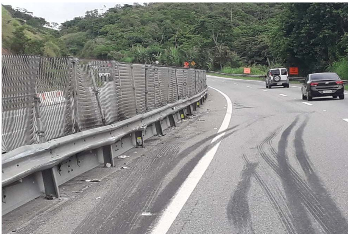
FOTO 07 - Dispositivo de Segurança - Km 05+700 Sul F1
