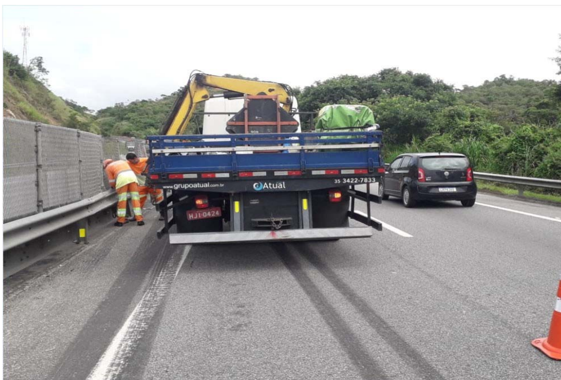
FOTO 08 - Dispositivo de Segurança - Km 05+700 Sul F2
